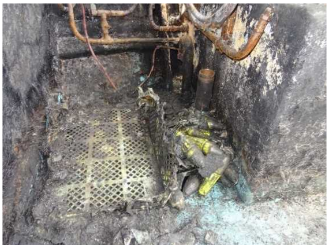
写真4 操業で使用していた水中ライト
