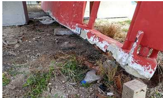
写真2 船底キール等の損傷状況
