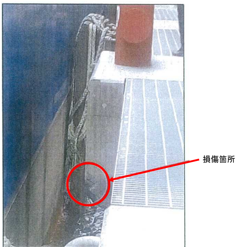
写真3 本件棧橋の損傷状況（下部）
