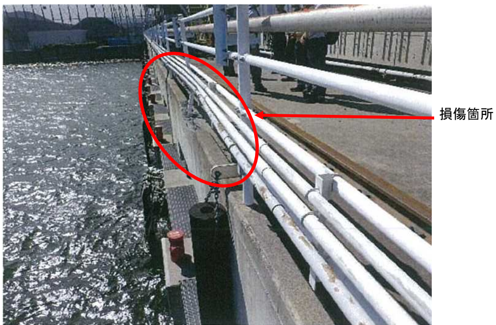
写真2 本件棧橋の損傷状況（上部）
