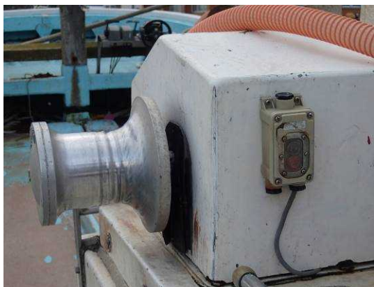
写真6 本件ローラの発停スイッチ
