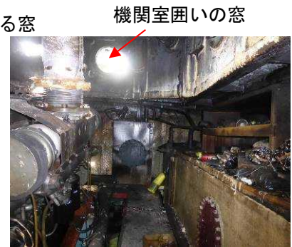
写真3 機関室右舷側
