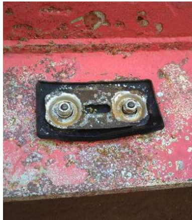
写真4 防食アルミニウム板の状態
