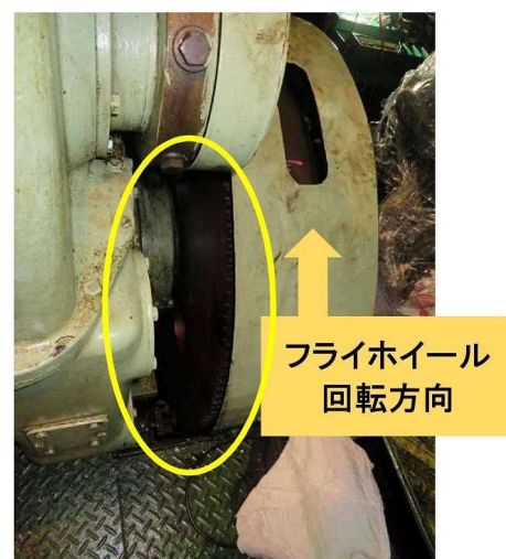
写真3 フライホイールからのビルジの噴出口
