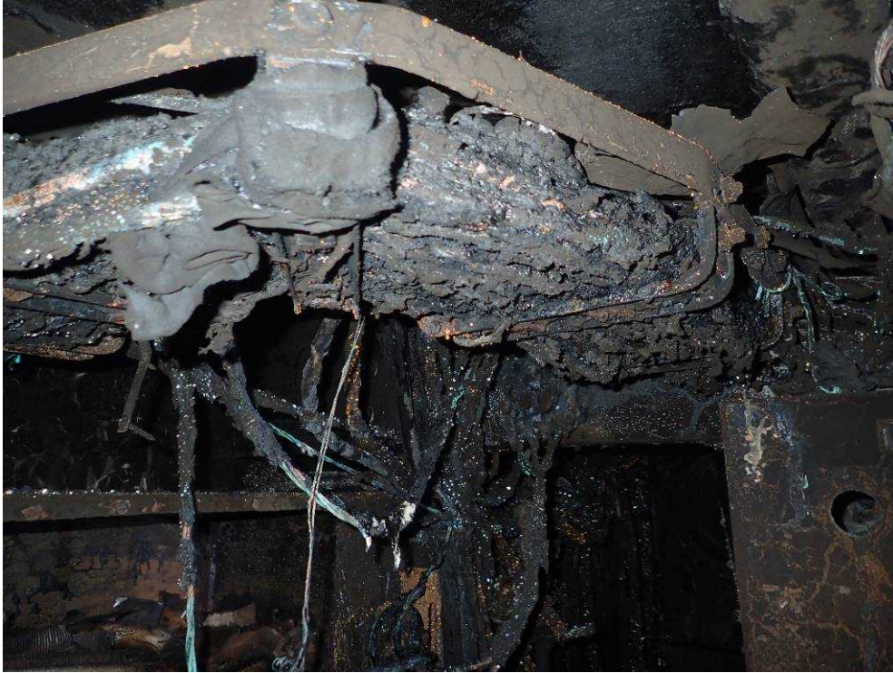
写真5 電線ラック焼損状況
