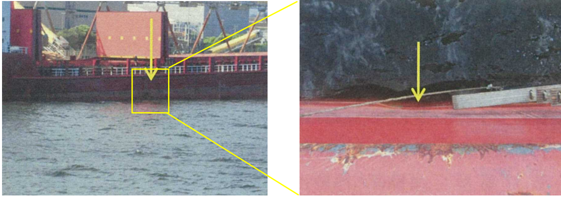
写真1 A船の損傷状況
