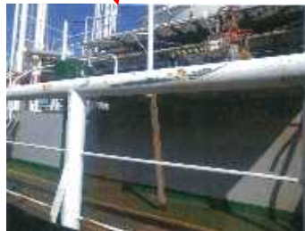
写真2 A船の損傷状況②
