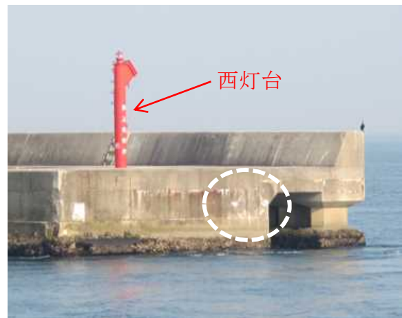
写真4 南防波堤西端の衝突痕
