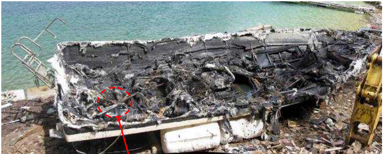
本件発電機が設置されていた場所
