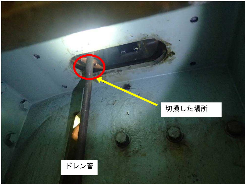
写真5 過給機のドレン管
