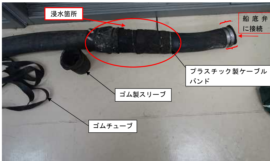
写真2 本件配管の浸水箇所
