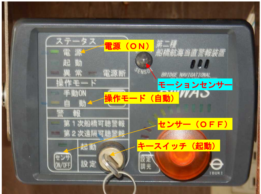
写真1 本事故時の本件警報装置の設定状況
