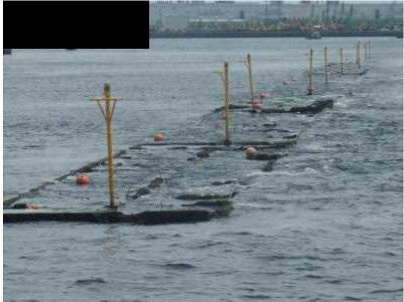
写真2 本件ケーソン（撮影時の潮高約6cm）
