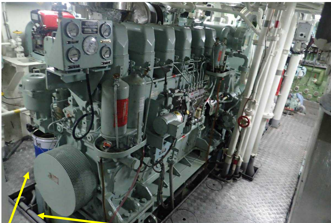
写真3 補助発電機原動機
