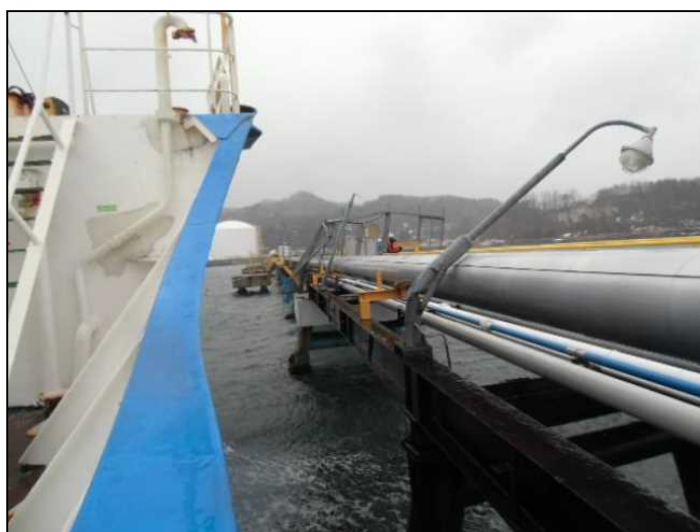
写真2 照明設備及び保安ゲートの損傷状況
