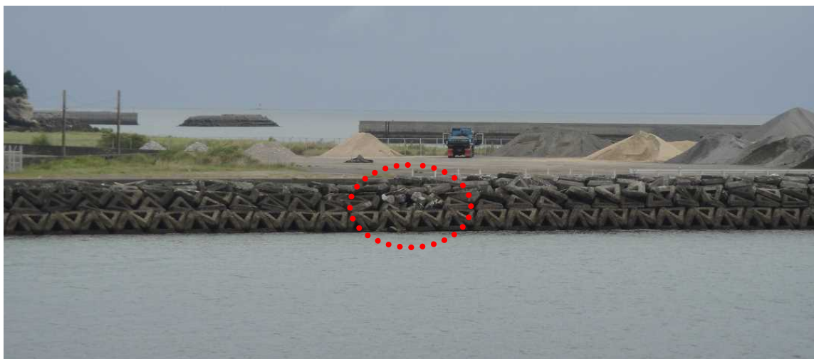
写真2 事故発生場所
