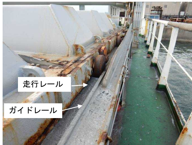
写真4 走行レール及びガイドレール（左舷中央部から船尾方を望む）
