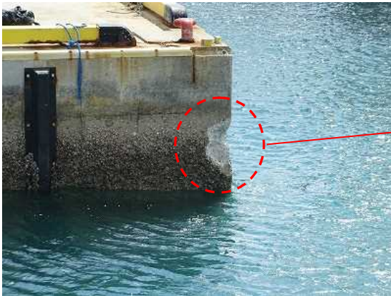
写真1 本件岸壁の損傷状況
