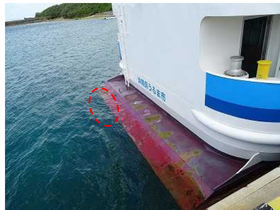
写真4 左舷船尾部の損傷状況
