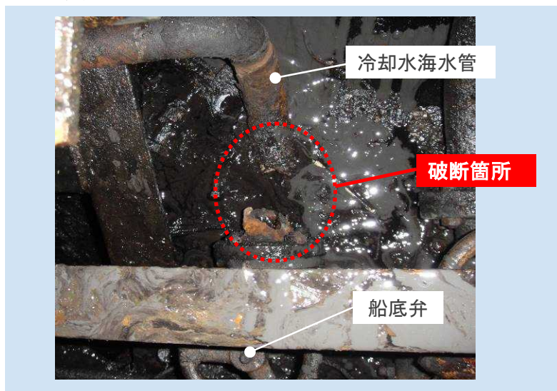
写真3 停泊用発電機の冷却海水管破断状況
