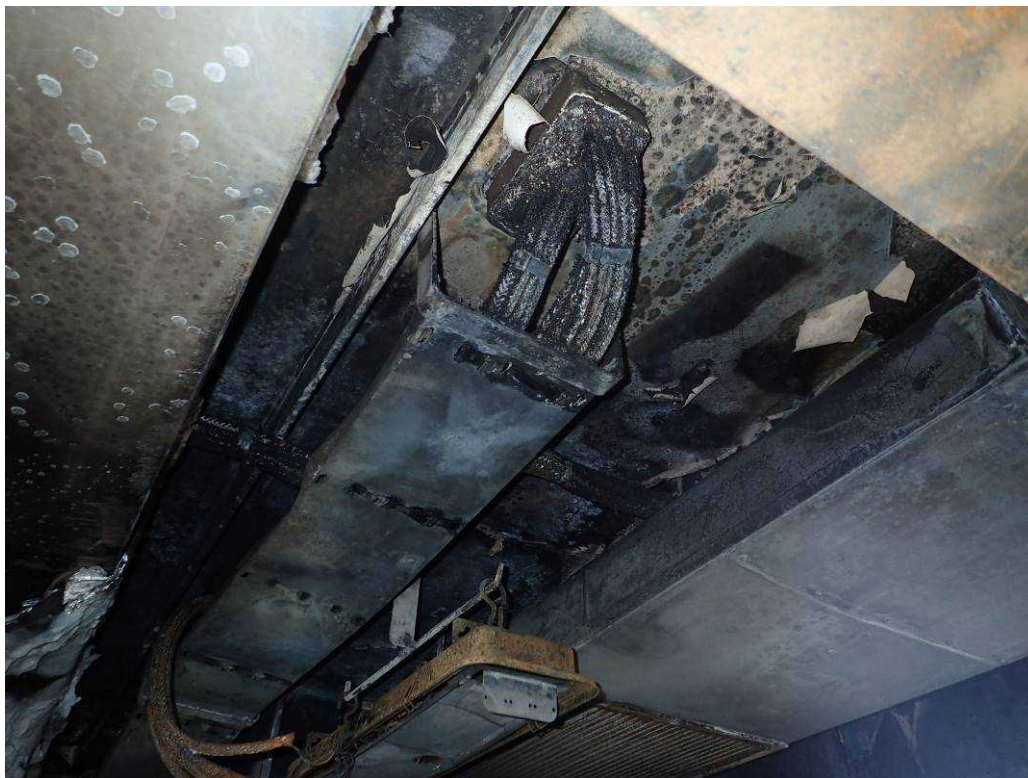
写真5 ポート甲板廊下天井（電線ダクト）
