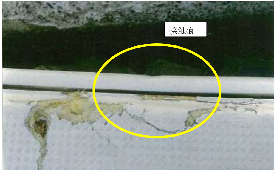
写真4 B船ブルワーク亀裂状況
