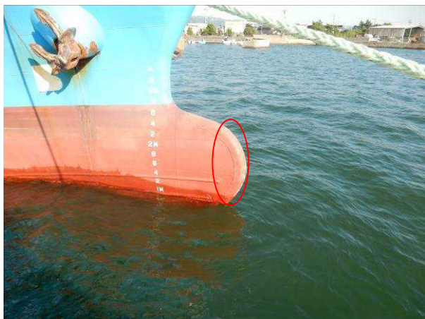
写真1 A船の損傷状況
