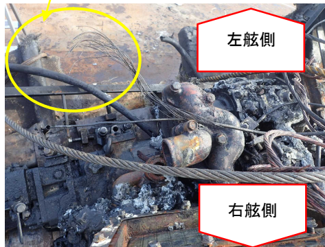
写真2 被覆が焼けた状態の電気配線
