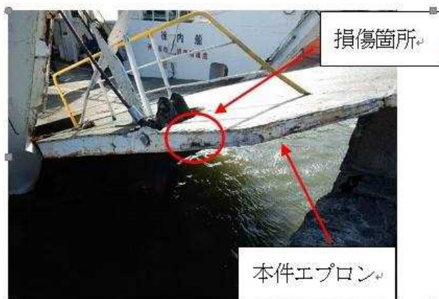
写真2 本件エプロンの損傷状況
