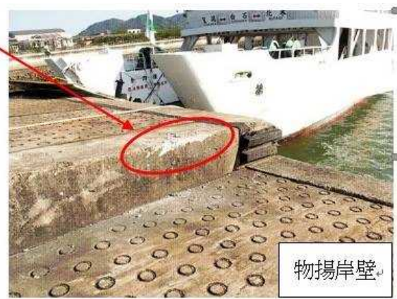
写真3 物揚岸壁の損傷状況
