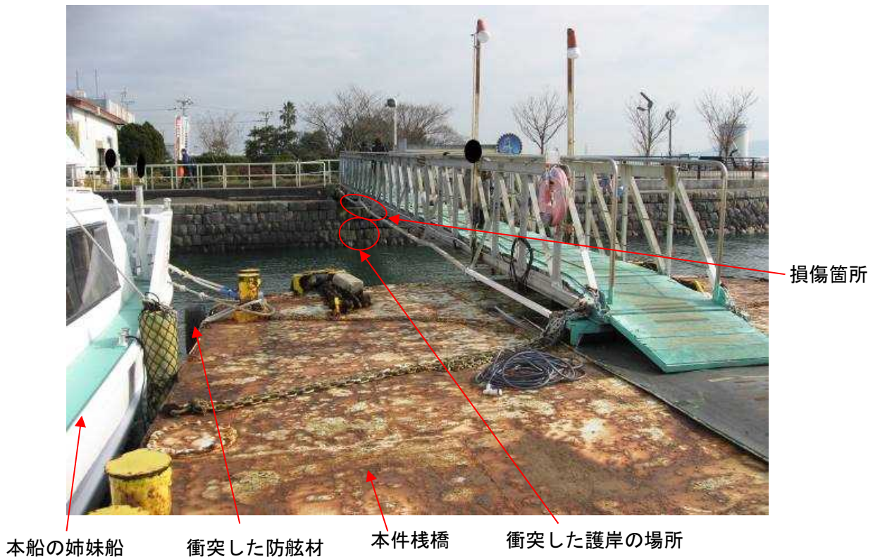
写真2 本件棧橋等の損傷状況
