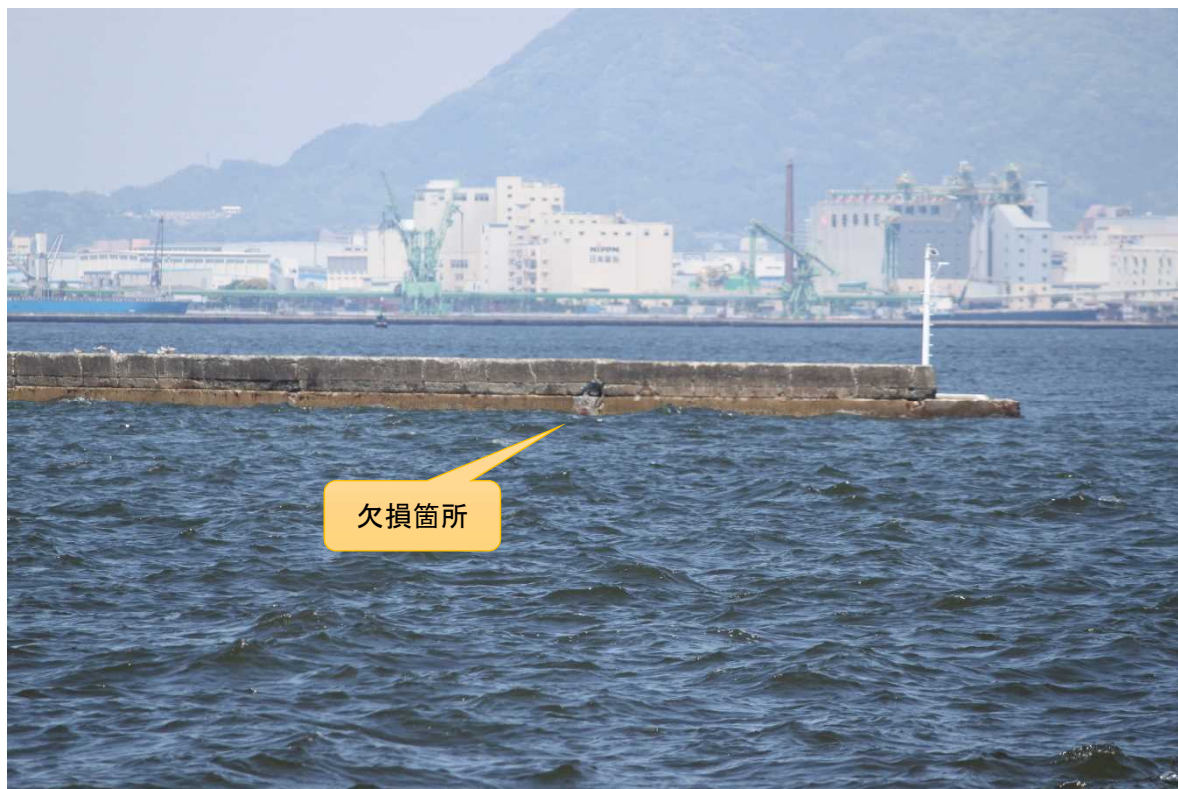
写真3 博多港西防波堤の損傷状況
