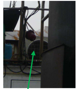
空調機の室外機 (船橋の上)
