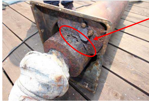
写真2 排気管亀裂部（消防本部提供）
