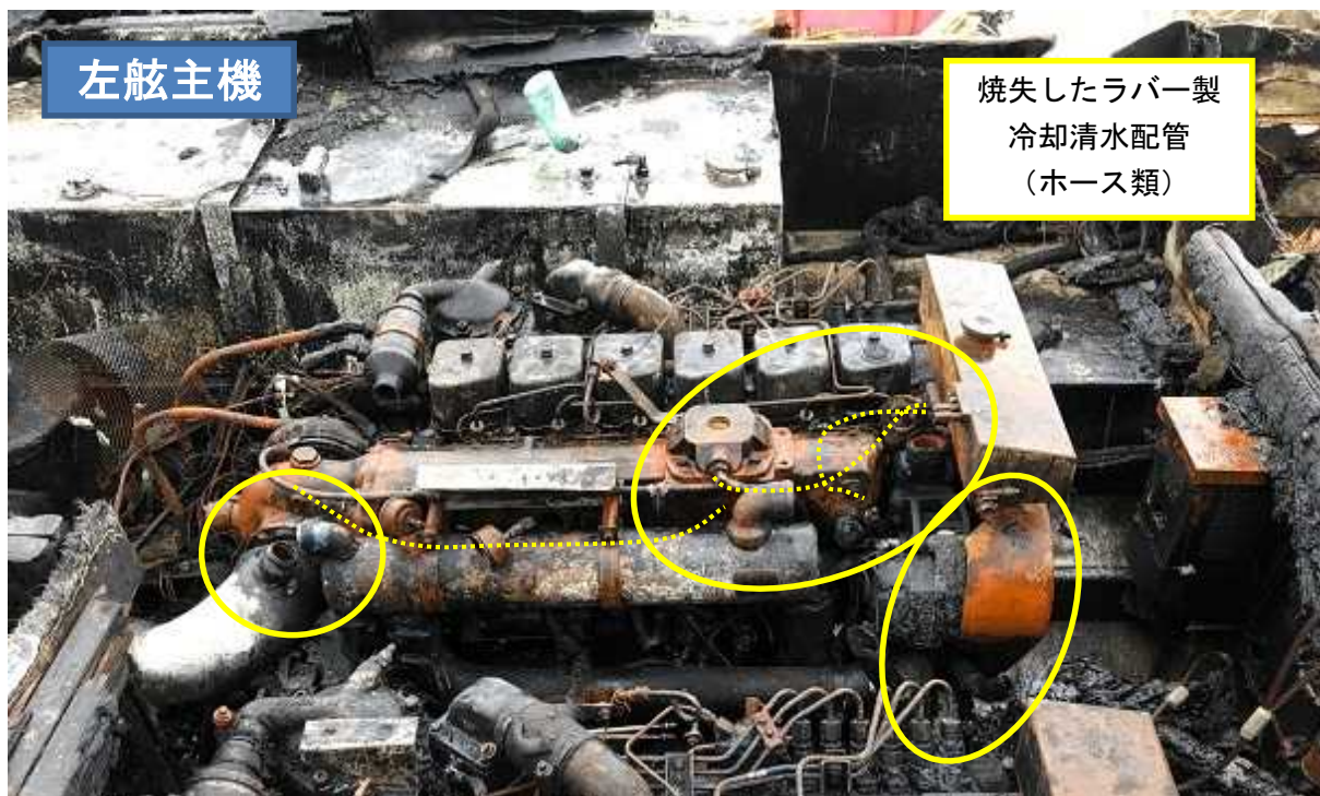
写真4 左舷主機の焼損状況
