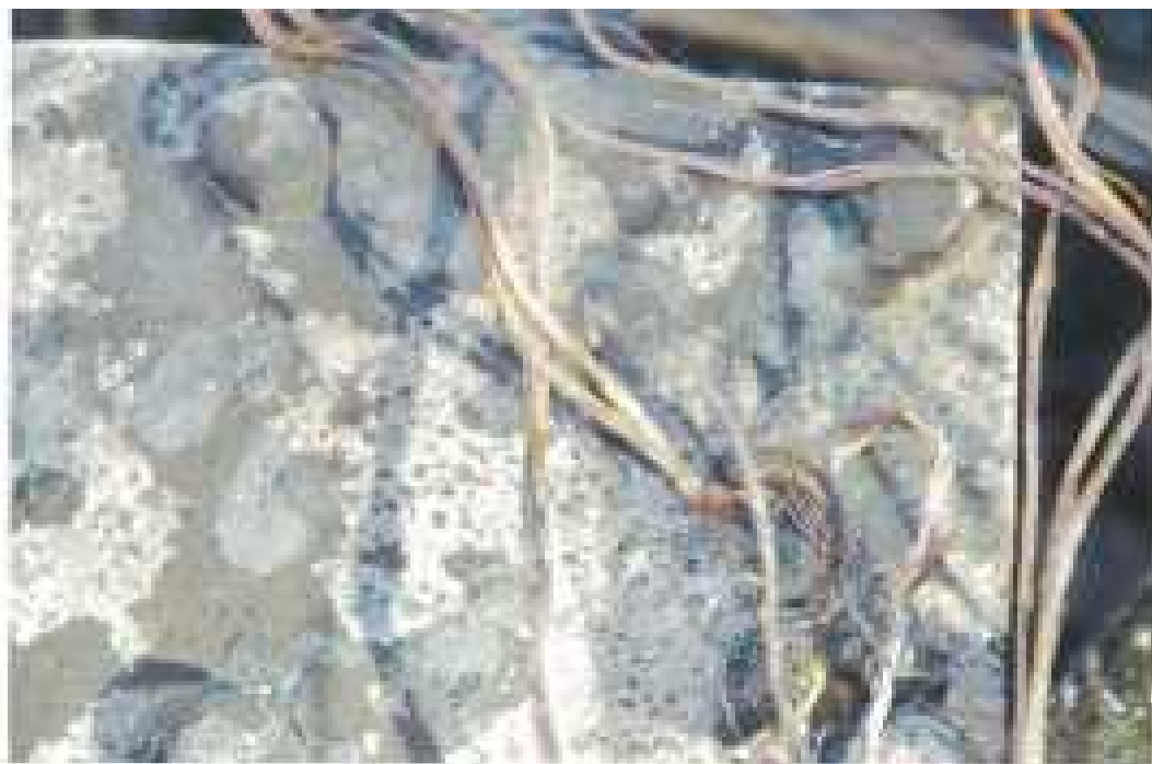
写真5 セルモータ用電線焼損状況
