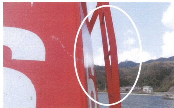
写真6 本件灯浮標の損傷状況（梯子の曲損）
