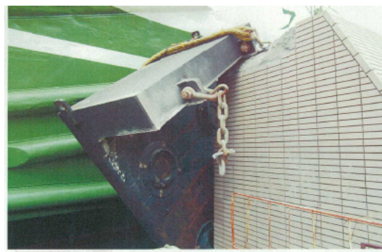
写真4 防衝工固定土台及び固定用鎖
