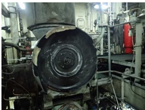
写真1 主機過給機 (タービン側)
