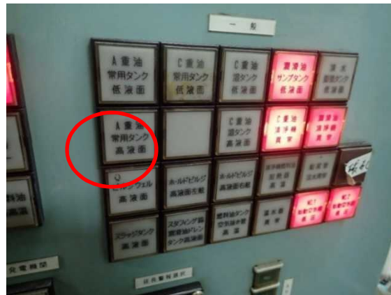
写真6 警報表示部（機関制御室）
