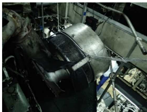
写真2 主機過給機 (コンプレッサ側)
