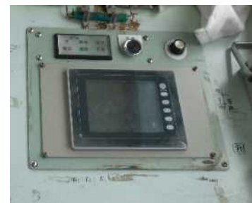
写真 2.5-2 本件連結装置の操作パネル
