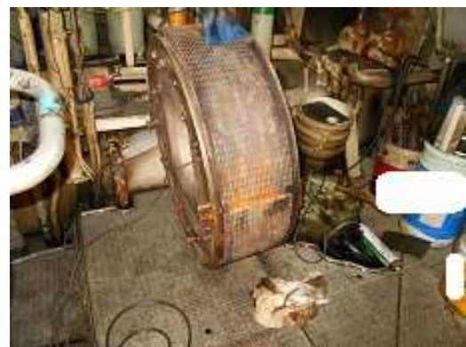
写真5 過給機エアフィルタ部の焼損状況
