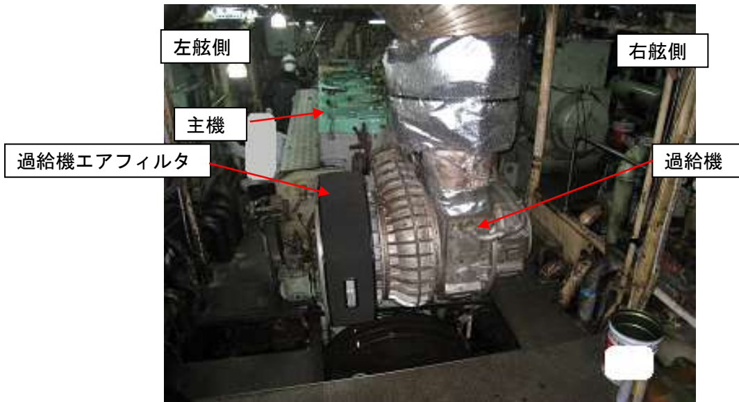
写真1 機関室（修理後）
