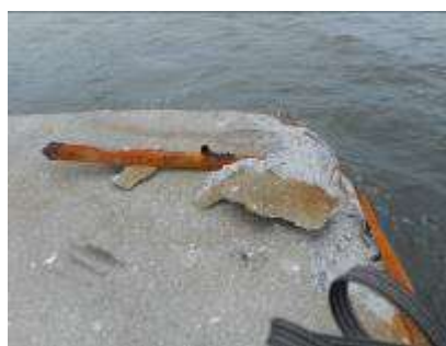
写真3 本件棧橋の損傷箇所
