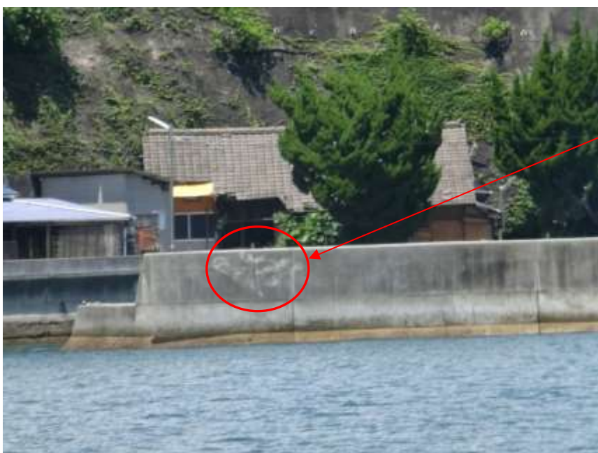
写真3 冠崎防波堤の損傷状況
