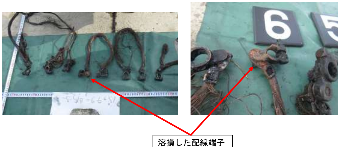
写真4 バッテリー配線端子溶損状況
