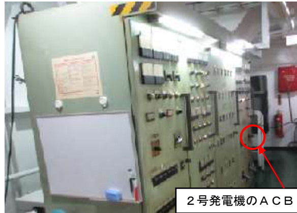
写真3 A船主配電盤
