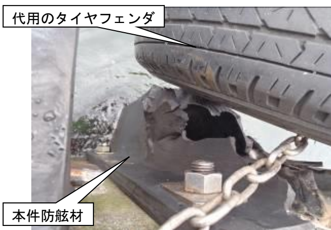
写真5 本件防舷材の破損状況
