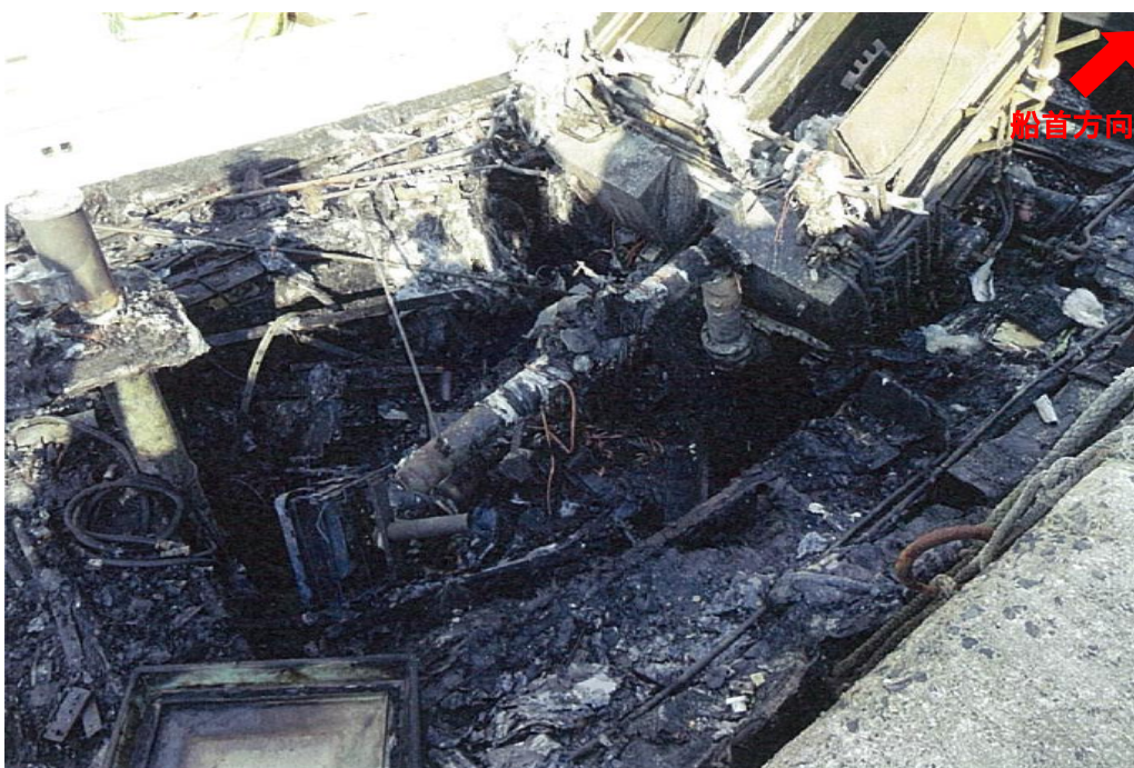
写真2 機関室の焼損状況
