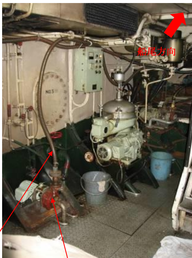
写真2 サニタリポンプの状況
