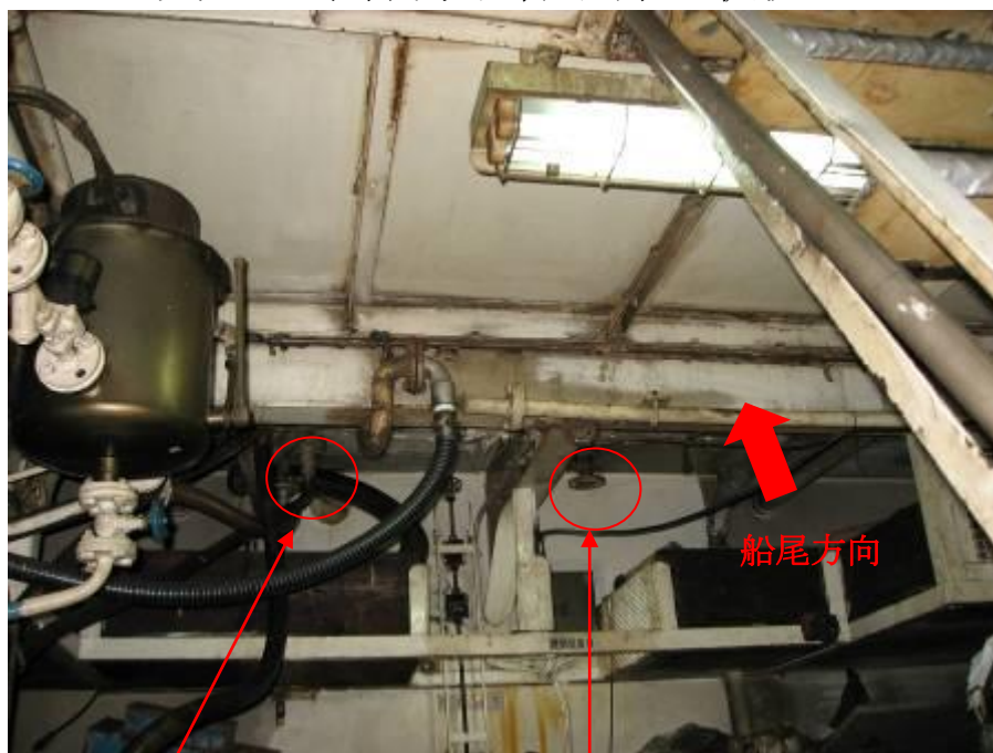
写真3 本件海水管端部の状況
