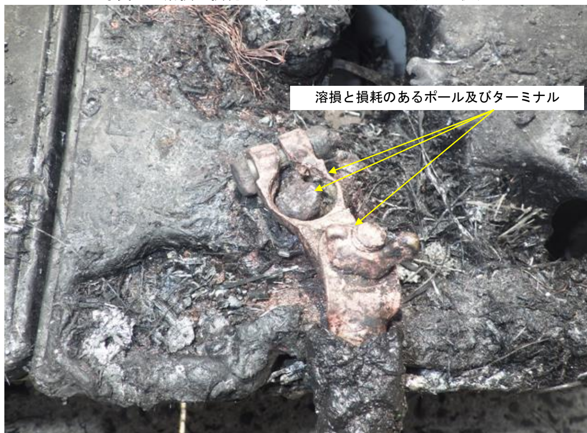
写真2 溶損と損耗のあるポール及びターミナルの状況
