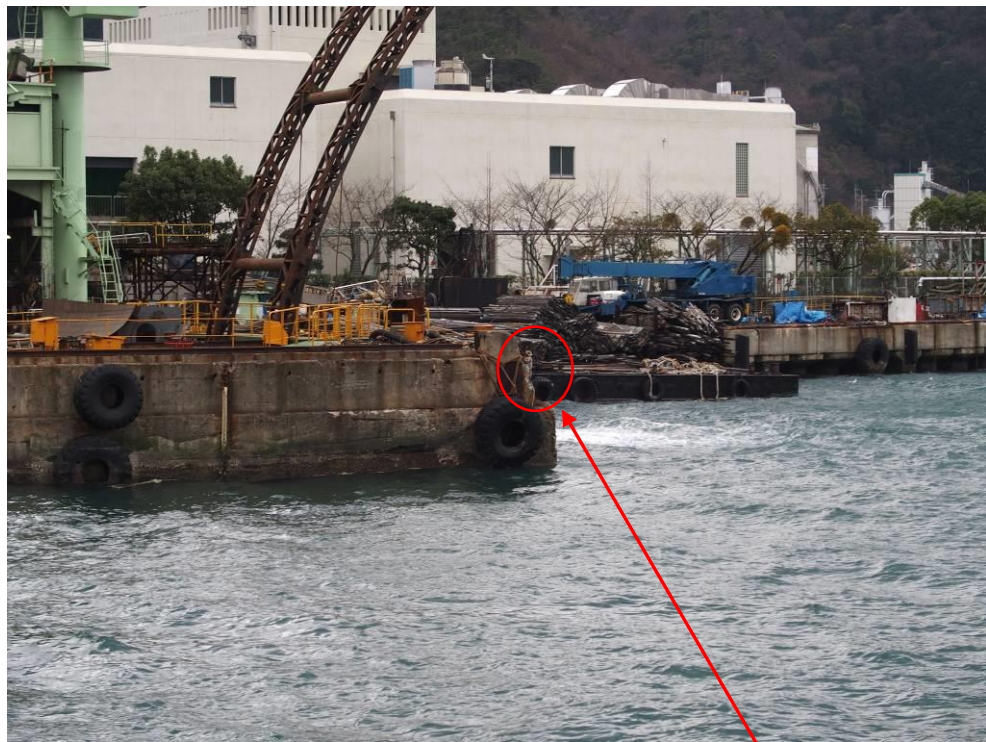
写真3 岸壁の損傷状況
