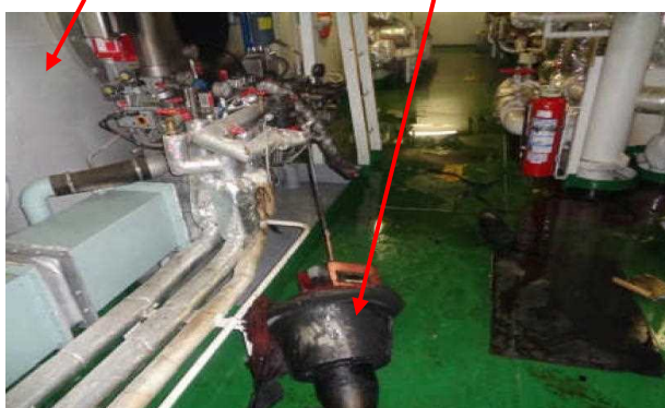
写真2.3-1 バーナユニットドア
