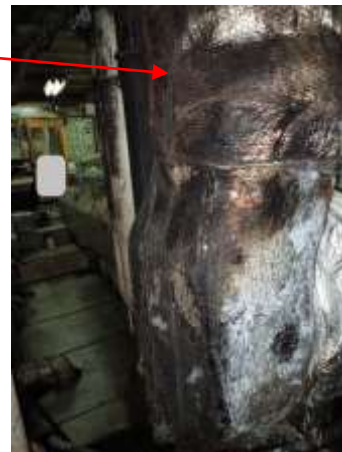
写真3 過給機焼損状況 (2)
