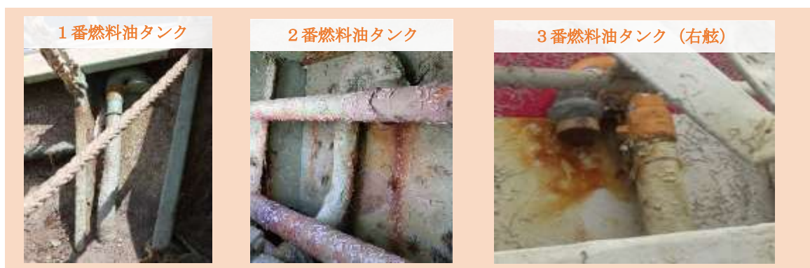
写真2.7-11 燃料油タンクエア抜き管
